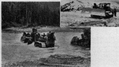
T. h. Till de högst belägna lägren transporteras förnödenheter med helikopter. Nedan: Trötta vägbyggare på väg hem till sitt läger efter en mödosam arbetsdag. Fordonet en TD-24.
