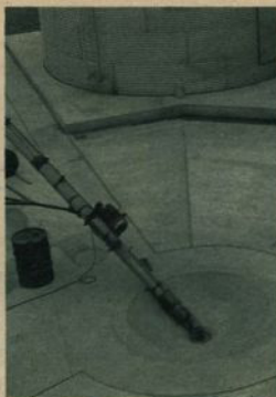
Bilderna på detta uppslag är ifrån en jättstor Butleranläggning i England. Detaljbilderna visar skruvarna och det gjutna fundamentet. Skruvarna används för fyllning och tömning och för "interna" transporter av spannmål mellan torkar och lagringssilor.
