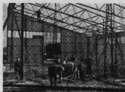
Järnkonstruktionerna till lagarskjulet reses med Ferguson. Här fästs en kolonn vid lyftapparatens förlängningsboom . . .
